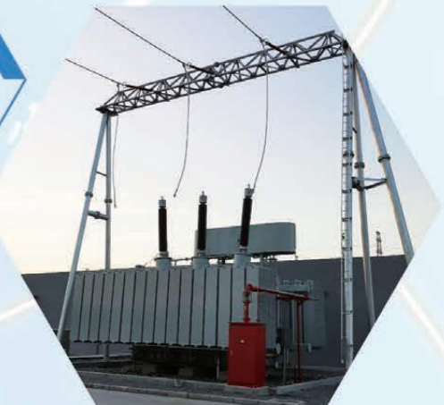
Subestación de 220kV en YiChuan, China 中国220kV伊川变电站
