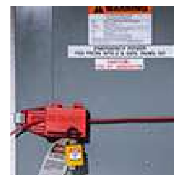
Bloqueo de paneles eléctricos
