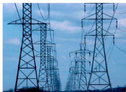
Líneas eléctricas de alta tensión para RED ELECTRICA DE ESPAÑA Ingeniería básica y de detalle
