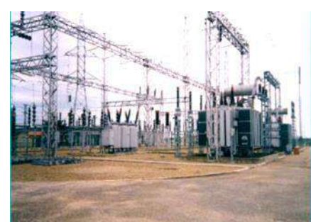
Evaluación de la calidad del suministro eléctrico de la Comunidad de Madrid CONSEJERIA INDUSTRIA MADRID
