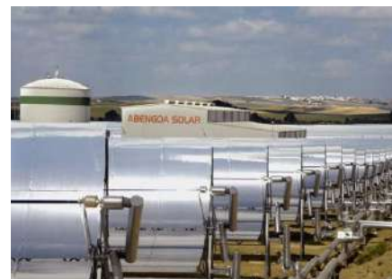
CTCC + Campo Solar de HASSI R'MEL ISCC ABENGOA (Argelia) Ingeniería básica y detalle
