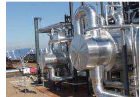
CSP Arenales OHL/MAN SOLAR MILLENNIUM 50 MW Ingeniería básica y detalle
