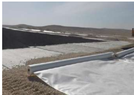
Gas Vertedero AL GHABAWI a Energía Municipio Great Amman, Jordania WORLD BANK + ERBD 900.000tpy, 156 pozos, 5MW Supervisión de Construcción
