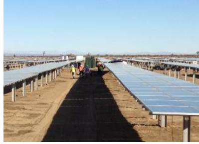
GES USA Parque Fotovoltaico de 2x2 MW en California Ingeniería de detalle
