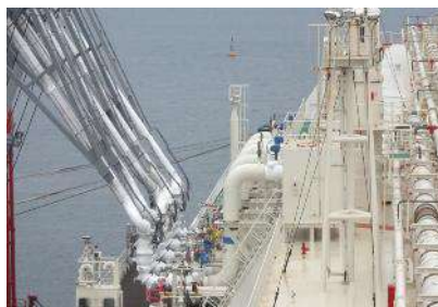
Almacenamiento de GNL, terminal de regasificación y Planta de Ciclo Combinado en Chile
