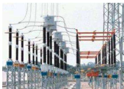
Más de 80 subestaciones (de 15 kV a 380 kV) para IBERDROLA Ingeniería de detalle
