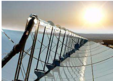
CSP Solaben THESAN CAPITAL 50 MW Due Diligence
