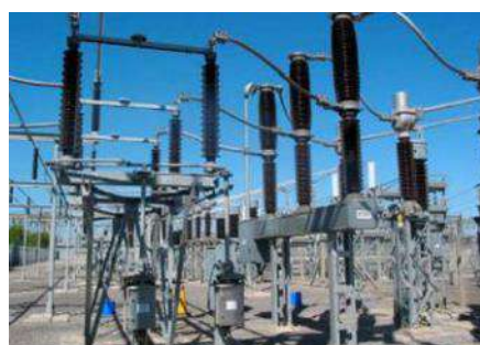
Subestaciones eléctricas (hasta 400 kV) RED ELECTRICA DE ESPAÑA Ingeniería básica y de detalle
