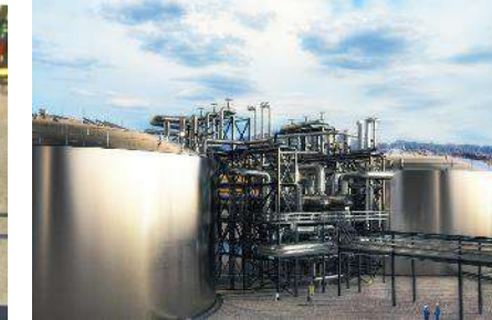
Planta de Demostración del Sistema de Almacenamiento de Energía SAMWAY (CHINA) Ingeniería básica y detalle
