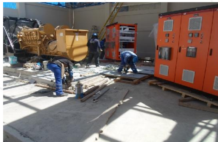
Instalación del grupo electrógeno, celdas de media tensión (22.9KV) y tableros de distribución (460V)
