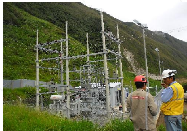
SE Casa Maquinas, transformador de 3.5MVA y 1,2MVA 34.5/0.46KV
