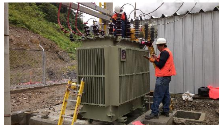
Pruebas en campo a transformador de 1.2MVA 34.5/0.46KV, SE Casa Maquinas
