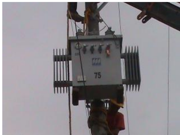
COMPONENTE ELECTRICO – ACOMETIDA Y TRANSFORMADOR
