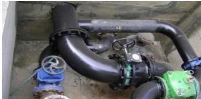
COMPONENTE HIDRAULICO- CAJA DE VALVULAS
