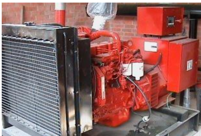
COMPONENTE ELECTRICO – PLANTA DE EMERGENCIA
