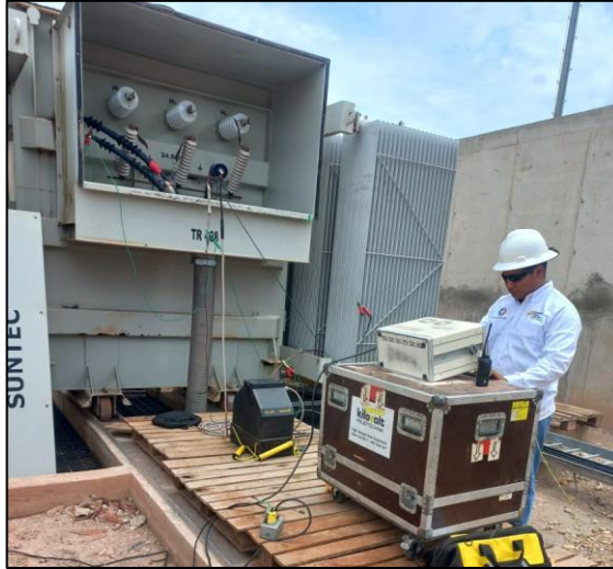
Pruebas VLF acometida 34.5 Kv
