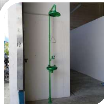
Cuarto de obras civiles Bodegas el Triunfo - Comercial Nutresa - Montería
