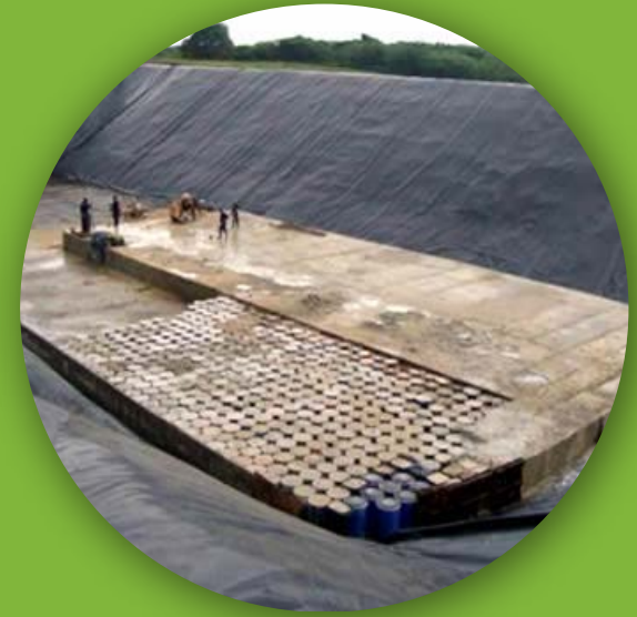
Celdas de Seguridad
