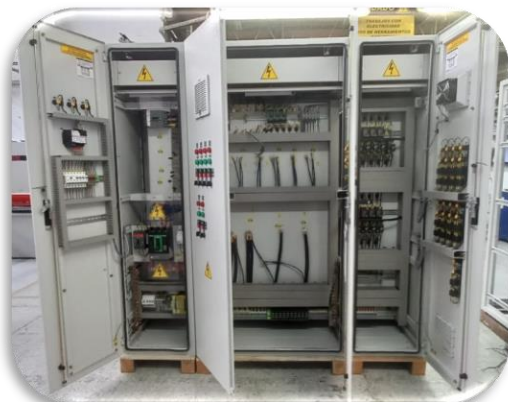
CENTRO DE CONTROL DE MOTORES TABLERO DE CLIMAS IKEA NQS BOGOTÁ 930A- 480VAC
