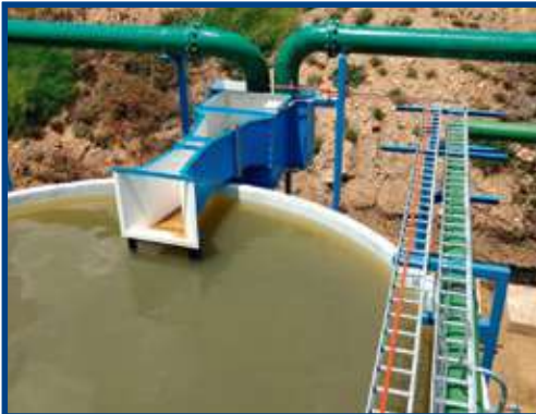
Canaletas parshall y vertederos
