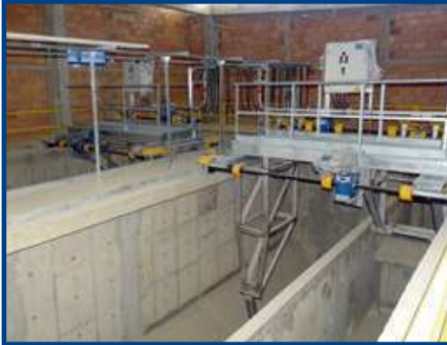
Puentes barreadores para remoción de flotantes
