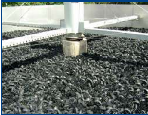
Filtros percoladores (biofiltros)
