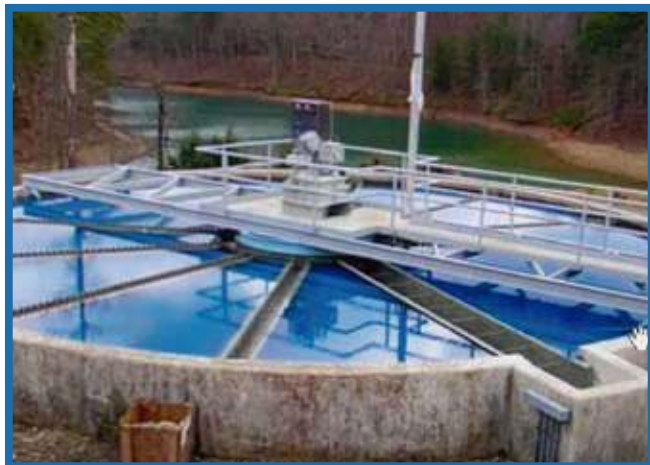
CLARIFICADOR DE SEDIMENTACIÓN ACELERADA (JAMAICA)
