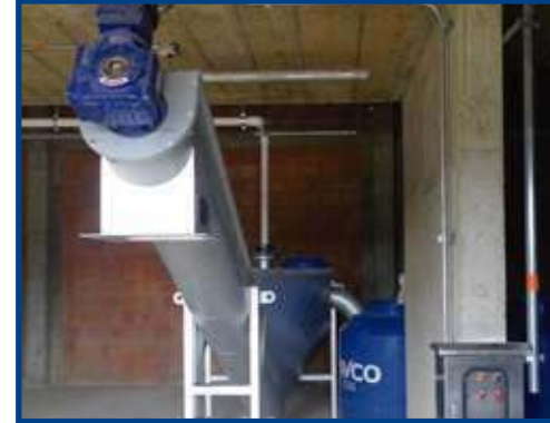
Tornillos deshidratadores de lodos
