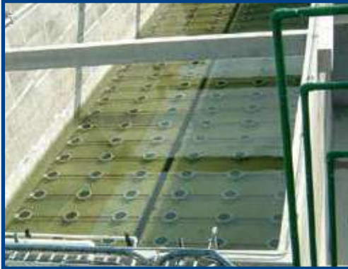
Tratamientos aerobios de lodos activados
