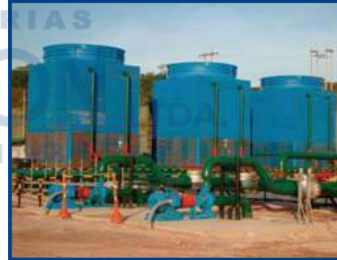
Torres de enfriamiento para aguas residuales
