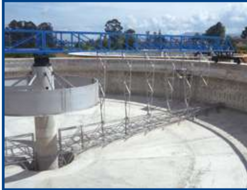
Clarificadores primarios/ secundarios con puentes barredores cilíndricos
