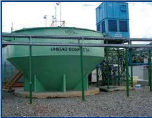
Clarificadores de manto de lodos para potabilización
