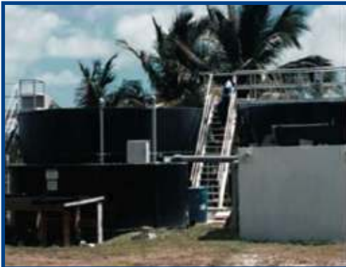
Tratamientos aerobios de lecho móvil MBBR
