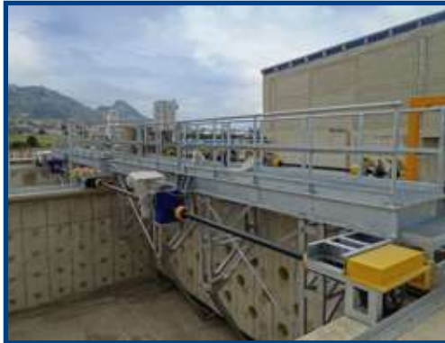
Clarificadores primarios/ secundarios con puentes barredores longitudinales
