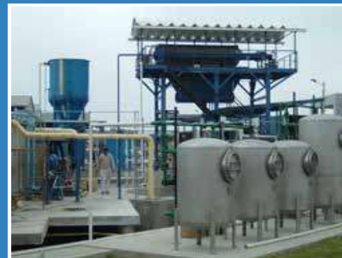
SISTEMAS DE DESHIDRATACIÓN DE LODOS
