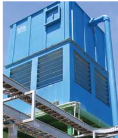
TORRES DE AIREACION
