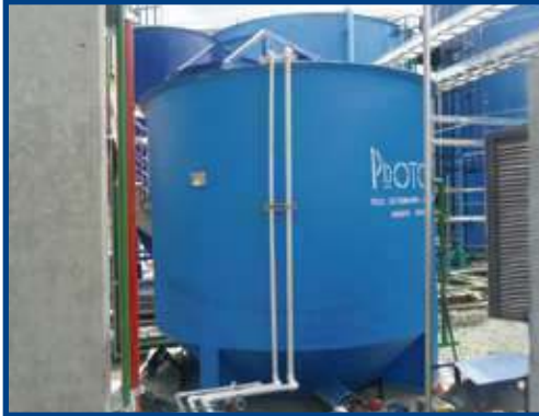
Sistemas de acondicionamiento de lodos
