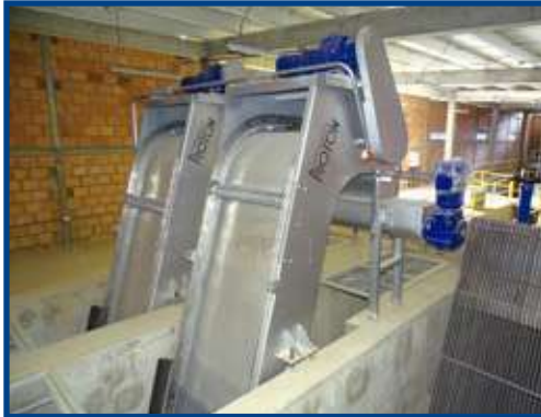
Rejas de desbaste manuales y autolimpiantes
