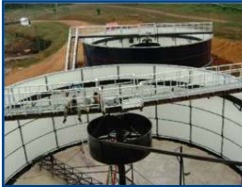
Clarificadores primarios/ secundarios con puentes barredores cilíndricos
