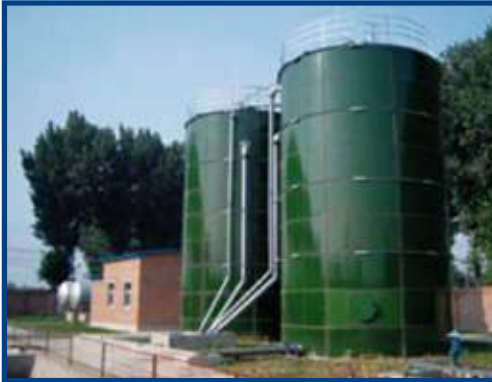
Tratamientos anaeróbios UASB
