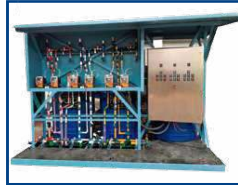
Unidades de dosificación de químicos
