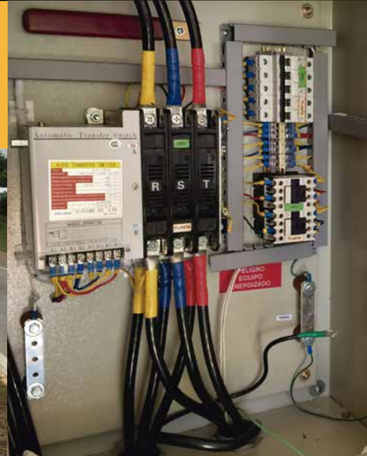
Red eléctrica báscula pesaje La Lizama Transferencia Automática CONSECON RUTA DEL SOL II
