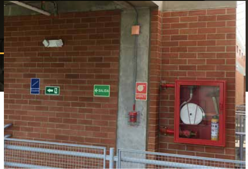
Sistema de detección incendio, rutas de evacuación colegio Luis Enrique Barón - MANI CASANARE
