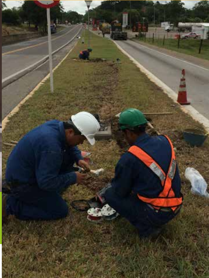
Red eléctrica para sistema de iluminación Carril de acceso 1 Báscula La Lisama CONSECON RUTA DEL SOL II
