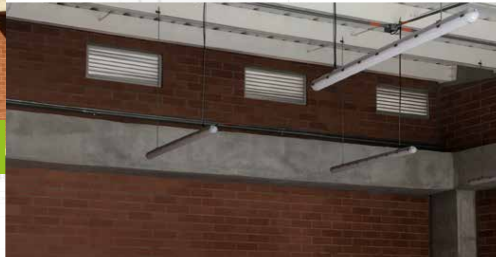
Sistema de iluminación aulas colegio Gustavo Villa Díaz - ARAUCA
