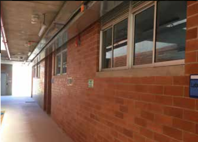
Bandeja portacable y tubería Red Eléctrica e iluminación Colegio Luis Enrique Barón MANÍ - CASANARE
