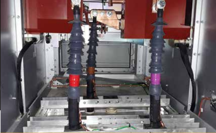
Conexión terminal en celda SUBESTACIÓN ELÉCTRICA EL HUCHE
